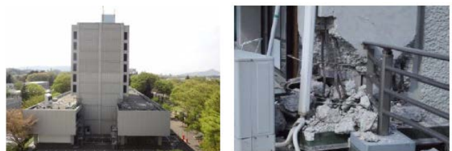
写真2 東側から見た被災建物
